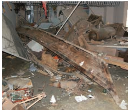
館内被災状況
